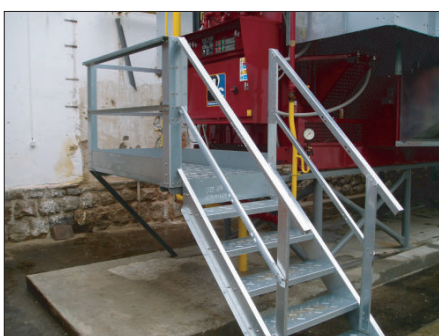
Plošina a rozvaděč
